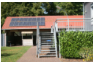
Photovoltaikanlage Nutzung regenerativer Energien (Sonnenenergie) mittels einer Photovoltaikanlage
